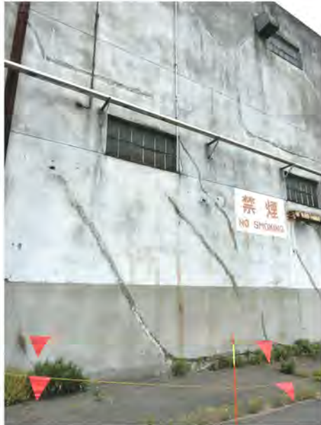
ひび割れのある稲永ふ頭の上屋 立ち入り禁止の柵が建てられています
