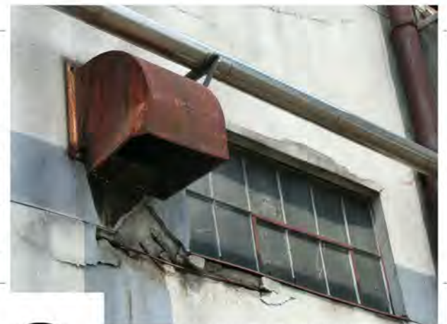
コンクリート片が落下し、 ガラスも割れている状況
