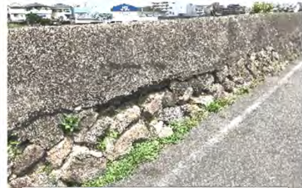
コンクリートが剥がれ落ちた堀川堤防
